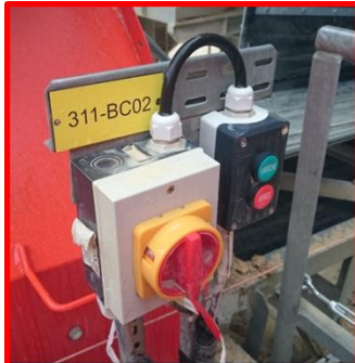
Interrupteur de proximité défectueux et boîtier déporté avec commande Marche /arrêt
