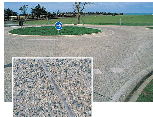
Giratoire des Campani (RD 735) : structure béton à joints non goujonnés sur fondation en g rave ciment.
