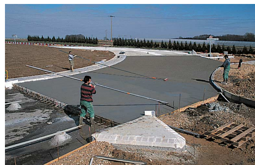
Bétonnage de l'anneau du giratoire et du dispositif de raccordement à la bretelle.
