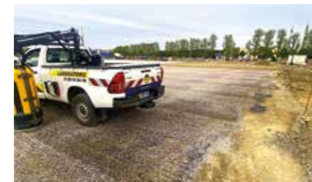
↑ Contrôle à la dynaplaque de la portance de la CDF traitée. ©Medinger & Fils
