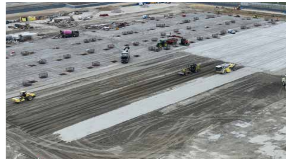
← Phasage optimisé du chantier. À l'arrière-plan, la construction du bâtiment en cours. Au premier plan, la réalisation de la CDF traitée pour les voies et aménagements extérieurs. ©Medinger & Fils
