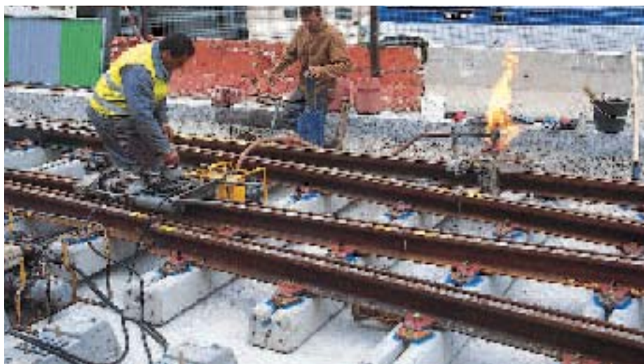
Des traverses préfabriquées en béton supportent les rails.
