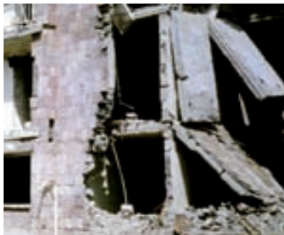
Fig. 80 - Arrachement de planchers lors d'oscillations sismiques
