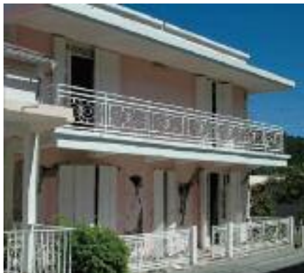
Fig. 12 - Fissuration des murs et trumeaux en croix, séismes de Guadeloupe 2004 et de L'Aquila, Italie 2009
