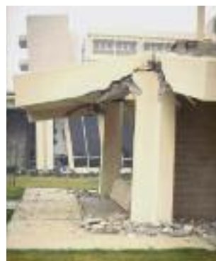
Fig. 15 - Rupture de porte-à-faux sous l'effet d'oscillations verticales
