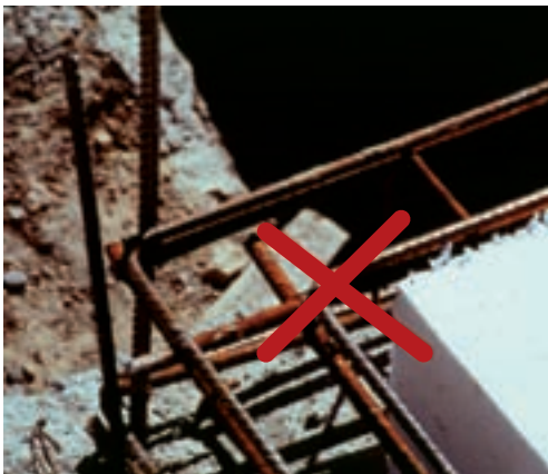
Fig. 59 - A éviter: disposition des armatures longitudinales donnant lieu à une poussée au vide. En outre, les armatures du chaînage vertical se trouvent à l'extérieur de celles du chaînage horizontal, ce qui est inacceptable
