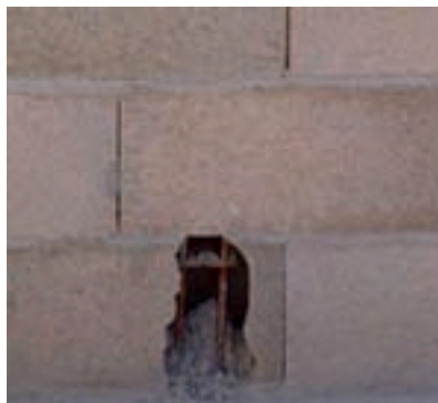
Fig. 67 - Trous de visite permettant de vérifier le remplissage des chaînages verticaux. L'image montre un remplissage incorrect
