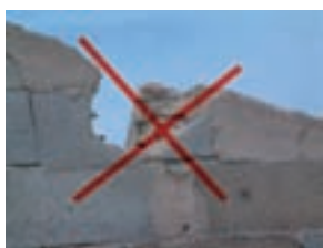
Fig. 64 - Chaînage coupé pour la pose de pannes de toiture : cette disposition est proscrite. En bas vue de détail
