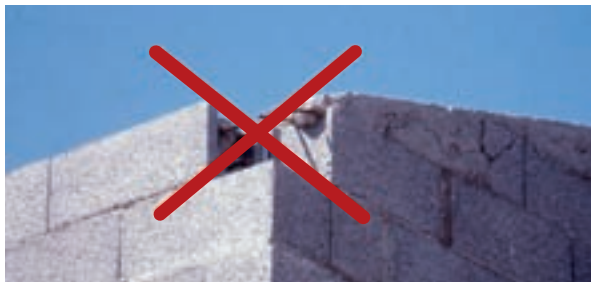
Fig. 61 - Absence de continuité du chaînage en angle. La fonction « chaînage » n'est pas assurée: cette disposition est inacceptable
