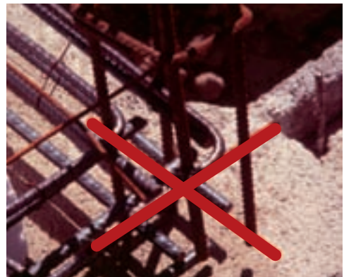
Fig. 60 - A éviter: la disposition des armatures longitudinales est correcte mais le chaînage vertical est excentré. En outre, les armatures de recouvrement du chaînage vertical (attentes) sont absentes
