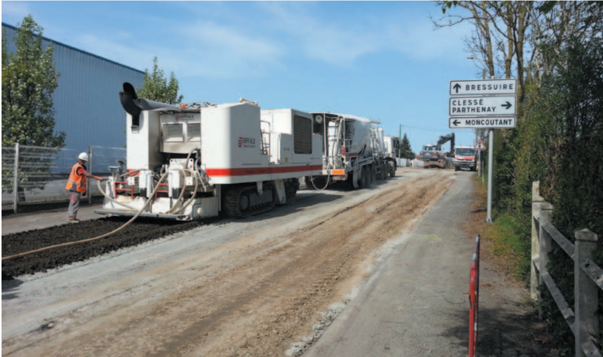
L'atelier de retraitement en place à froid aux liants hydrauliques d'Eiffage en action à l'entrée sud de la commune de La Chapelle-Saint-Laurent (au premier plan : l'ARC® 1000).
