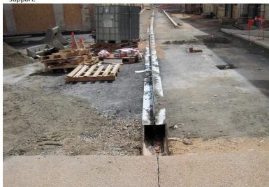
Rue de la République. Fondation en grave-bitume épaulant le caniveau à fente.
