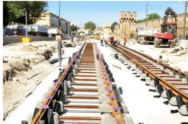
Les rails posés sur des traverses biblocs en béton, préfabriquées par Sateba. En gros plan, à droite, la partie sous patin de l'habillage des rails en mousse polyuréthane. Ces pièces (semelles élastiques) garnissent les rails avant le coulage du béton de calage. D'autres pièces viendront garnir les flancs du rail avant le coulage du béton de revêtement.
