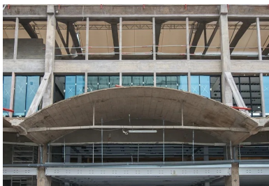
La légèreté de la structure est due aux auvents suspendus et stabilisés par des tirants métalliques noyés dans le béton.
