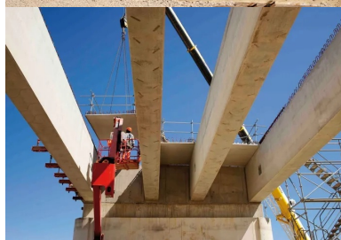
Pour l'ouvrage de franchissement du Vidourle, des prédalles collaborantes prennent appui sur les poutres.
