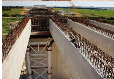
Long au total de 345 m, le viaduc du vistre comporte un ouvrage droit de 261 m de type quadripoutres en béton armé.
