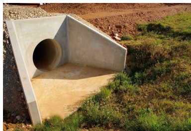
Buses et dalots facilitent l'écoulement de l'eau sous la plate-forme.
