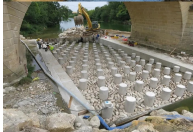
Les « menhirs » de 50 cm de diamètre et hauts de 90 cm, laissant une hauteur utile de 50 cm, sont ancrés dans un radier en béton armé. au-dessus, des enrochements secondaires disposés de façon aléatoire ont été scellés dans un bain de mortier.
