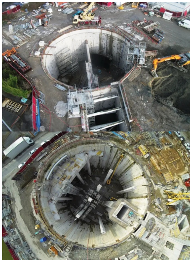
La station de pompage avec la bache de réception en partie centrale.
