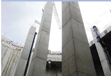
Les poteaux de 25 m de hauteur à l'intérieur du bassin de stockage.
