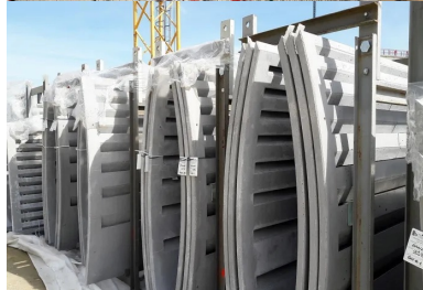
Les bandeaux de rives du tablier sont constitués d'une succession de 2 000 panneaux préfabriqués en béton fibré à ultra hautes performances.
