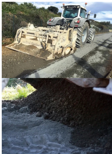
En action sur le chemin du Bousquet, en octobre 2015, le « tracteur muni d'un malaxeur » loué à la société nîmoise Ecostab, spécialisée dans le traitement des sols.
