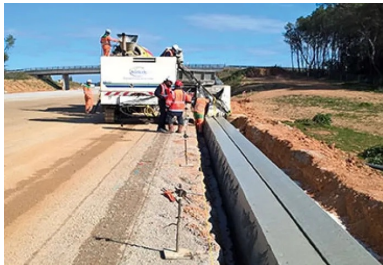
Au total, Agilis réalisera 90 km de séparateurs simples en béton adhérent (GBA) (photo du haut) et 12 km de caniveaux à fente (photo du bas).
