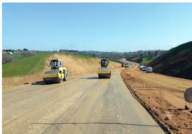
Le tronçon 2 x 2 voies sur 4,5 km implique la création d'une plate-forme de 25 m, qui nécessite environ 700 000 m 3 de terrassement. Au total, l'opération une fois achevée se soldera par le traitement de 115 000 m 2 de couche de forme au liant hydraulique routier.
