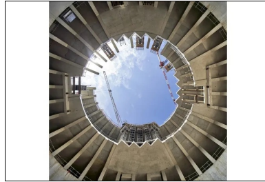
Constituant l'enceinte de l'infrastructure, les contre-voiles circulaires en béton autoplaçant reprennent les planchers et intègrent les méga-poteaux.
