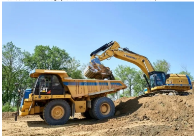
Reprise des déblais sur stock à l'aide d'une pelle sur chenilles et de tombereaux articulés. (© Guintoli - NGE)
