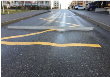
Photo 3 : arrêt de bus déformé - (c) CIMBETON
