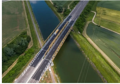
Vue aérienne du viaduc du canal de dérivation de la Saône rénové sur l'A36 (photo Sémaphore & Co). L'ouvrage est constitué d'un double tablier mixte de 100 m de long à poutres extradossées de type Warren. Le chantier de réfection de l'étanchéité était soumis à deux contraintes d'exploitation : l'impossibilité de couper la circulation des véhicules sur l'autoroute et des péniches sur le canal.
