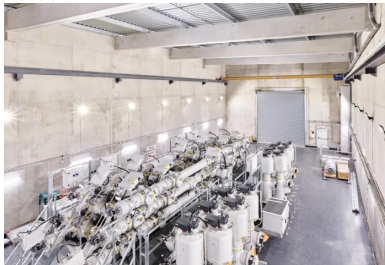
Vue du PSEM (poste sous enveloppe métallique) dont les parois en béton brut reçoivent une lasure incolore en guise de protection anti-poussière.
