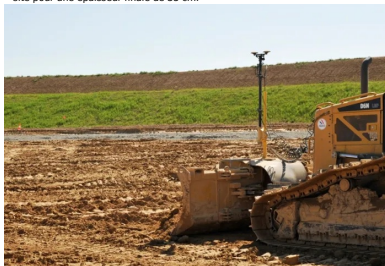
Préréglage à l'aide d'un bull asservi GPS afin d'obtenir une épaisseur homogène avant traitement.
