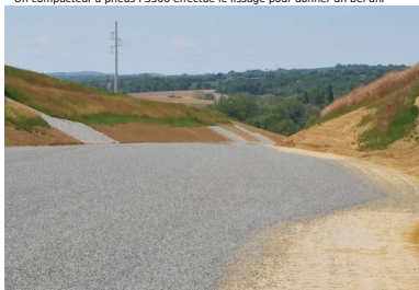
Un enduit monocouche prégravillonné a été appliqué pour protéger la couche de forme et assurer une bonne prise hydraulique du mélange
