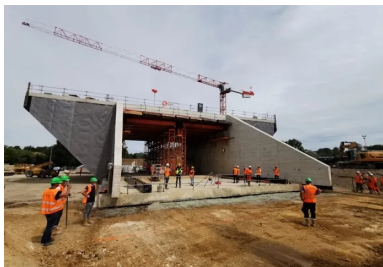
Une fois la brèche créée dans le remblai ferroviaire, le parcours de ripage a été scalpé à la bonne cote, afin de permettre à l'ouvrage de glisser sans effort excessif. Le ripage proprement dit a alors pu se dérouler : huit heures ont été nécessaires pour faire parcourir au pont-rail de quelque 6 500 tonnes les 49 mètres qui le séparent de son emplacement définitif.
