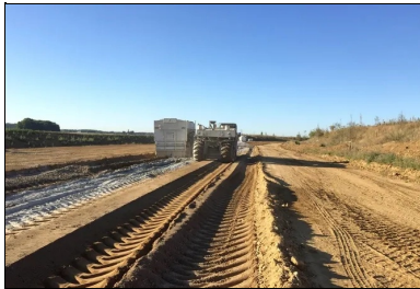
L'épannage du liant hydraulique routier ROC VDS d'EQUIOM à raison de 4,75 % (soit plus de 29 kg/m 2 ).
