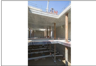
© ACTOPHOTO Utiles pour alimenter le chantier et évacuer les déblais, les trémies dispenseront la lumière naturelle dans les espaces souterrains. Les « préfondés » seront intégrés dans les poteaux ovoïdes de la station.
