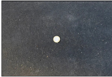
Trois finitions de surface et trois colorations sont mises en œuvre sur le parvis : béton sablé sur durcisseur charbon Viasol avec charge scintillante (quartz) pour les bandes sombres, béton imprimé « Empreinte pierre » sur durcisseur couleur sable pour l'effet roche brute et béton désactivé de couleur claire.
