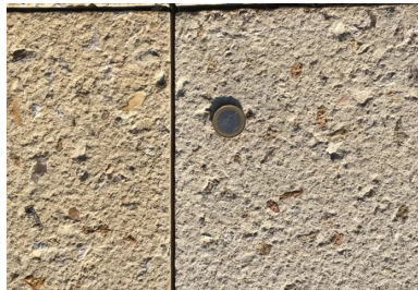
Les joints de retrait-flexion ont été réalisés le lendemain du coulage par sciage sur un tiers de l'épaisseur du béton, tous les 3 ml (piste cyclable) et tous les 1,5ml (voie piétonne).
