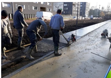
Le tirage du béton au rouleau Striker. Il n'a pas été vibré pour ne pas faire descendre le granulats, qui doit rester en surface pour le bon aspect visuel de la finition piquée.
