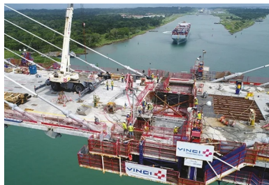
Le bétonnage de la zone de clavage permet de solidariser les deux fléaux du pont à haubans.
