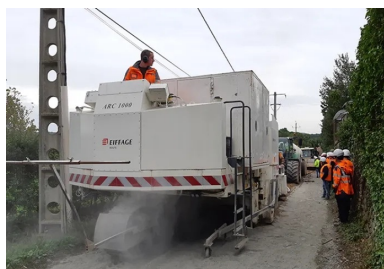
La chaussée est décohésionnée et malaxée.
