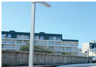
L'éclairage public a été entièrement repensé avec l'utilisation de diodes électroluminescentes (LED).
