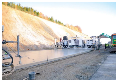
La seconde machine à coffrages glissants suit la première à une distance de 20 m. Elle met en œuvre la couche supérieure du BAC, frais sur frais, sur une épaisseur de 6 cm.
