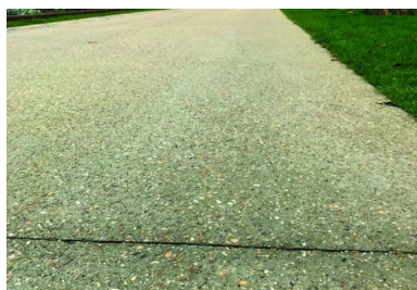
Le cheminement s'ouvre régulièrement, côté fluvial, sur des aménagements - façon belvédères - avec points de vue avancés sur la Seine (en arrière-plan). Au premier plan et en médaillon, un joint de dilatation.
