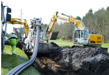
Disposés en tréfle au fond de la tranchée, les câbles sont recouverts de remblai liquide, puis la tranchée est comblée avec la terre excavée. Un grillage de plastique rouge inséré dans la tranchée signale la présence de la ligne haute tension.
