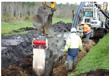
Disposés en tréfle au fond de la tranchée, les câbles sont recouverts de remblai liquide, puis la tranchée est comblée avec la terre excavée. Un grillage de plastique rouge inséré dans la tranchée signale la présence de la ligne haute tension.
