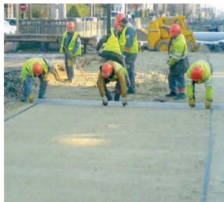
Etape importante : le réglage de niveau du lit de sable sous l'œil du géomètre.
