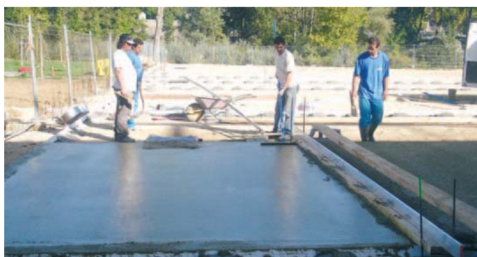
Le lissage du béton prêt à l'emploi, effectué rectangle par rectangle, permet de réaliser une surface bien plane.
