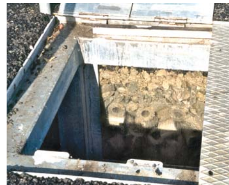
Regard de contrôle.
