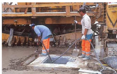
La machine à coffrage glissant a été modifiée pour franchir les émergences de réseaux.
