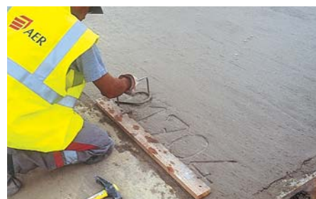
Chacune des dalles, coulées et sciées en carré de 5 m de côté, a été numérotée.
