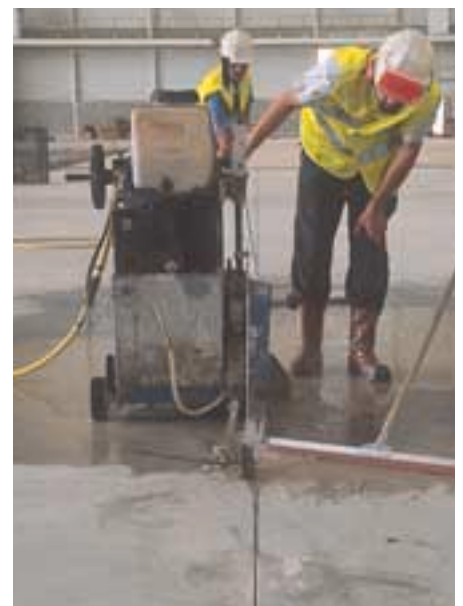
La scie diamantée permet de positionner avec précision les joints de retrait.
