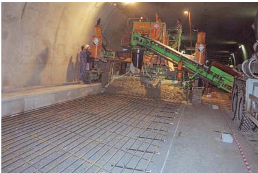
Le béton armé continu est adapté à la réalisation de linéaires importants.
