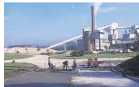
La variabilité des largeurs de chaussée a imposé une mise en œuvre manuelle.
