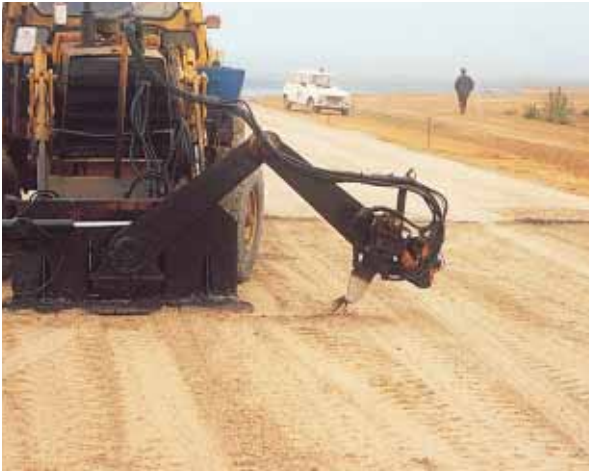
▲ Procédé LCPC-CBC : le soc, porté par un bras télécommandé, ouvre un sillon dans la grave-ciment.
