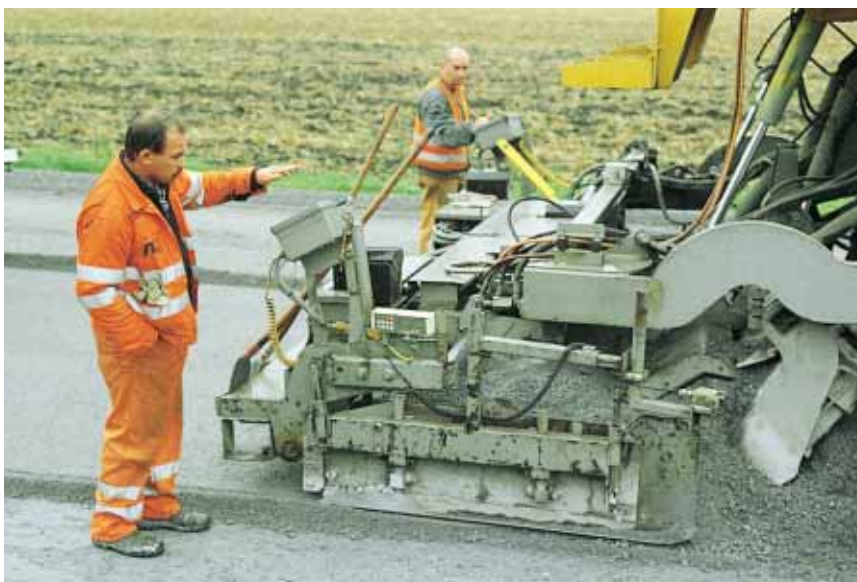
▲ La fraiseuse commence par décohesionner l'ancienne assise de chaussée en graves-cendres volantes sur 25 cm d'épaisseur.
