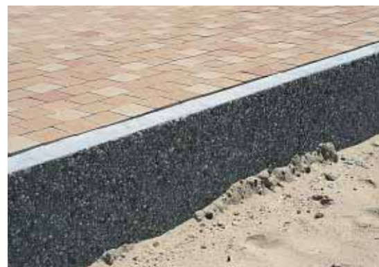
▲ Côté plage, les murets de soutènement en béton sont enterrés sur 80 cm.
