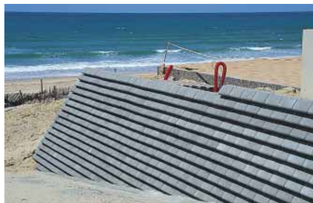
▲ La réalisation des accès à la plage à travers les dunes fait appel à des blocs béton spécifiques offrant une grande stabilité à l'ouvrage.
