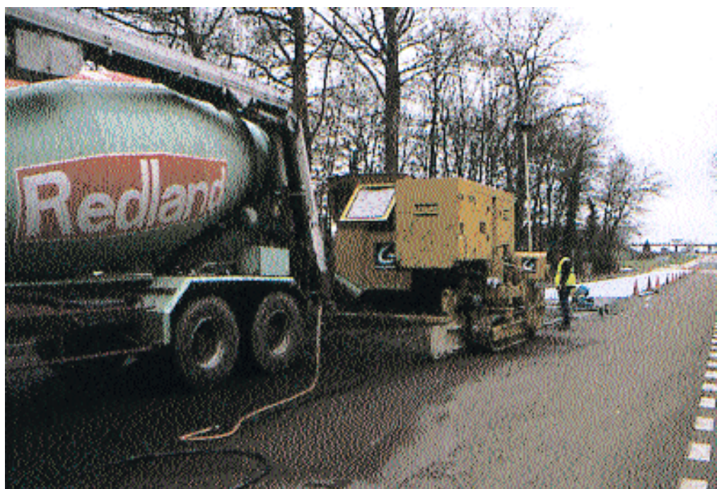
▲ Située sur l'autoroute A6 aux environs de Joigny, l'aire des Châtaigniers constitue la première référence en matière de béton de ciment mince collé (BCMC).
