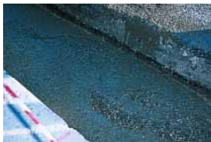
▲ Le BC Tranchées se répand uniformément dans la tranchée, limitant les opérations de réglage à un ratissage rapide. Les risques de décompression de la tranchée sont écartés du fait de la prise rapide du béton et d'un temps d'intervention réduit.
