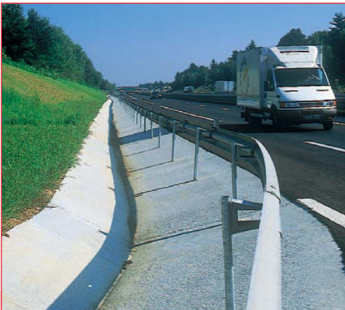
Les ouvrages hydrauliques en béton permettent de respecter la loi sur l'eau et son obligation de recueillir, puis de filtrer les eaux de ruissellement avant de les rejeter dans l'environnement.
