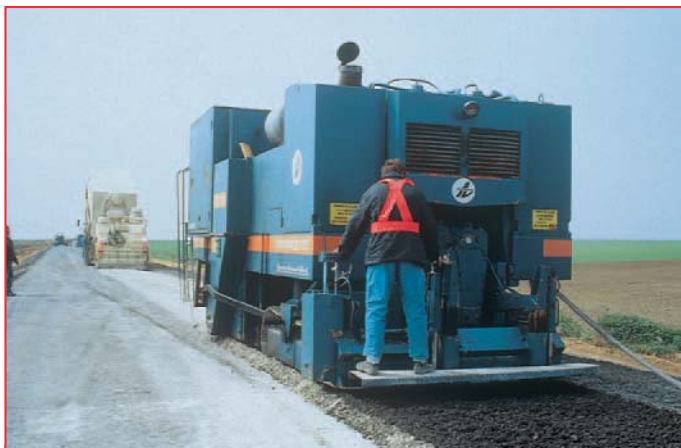
Le retraitement des chaussées en place au ciment ou aux liants hydrauliques routiers épargne les ressources en granulats et supprime les nuisances dues à leur transport.
